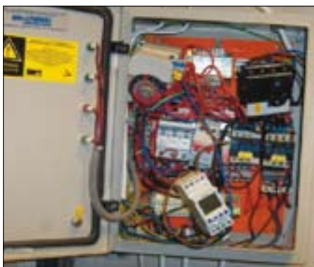
El-tavle til kuldeteknisk anlegg. Elendigheten avdekkes av el-tilsynet. Anlegget er omfattet av service- og vedlikeholds-avtale og ikke rørt av eier.
