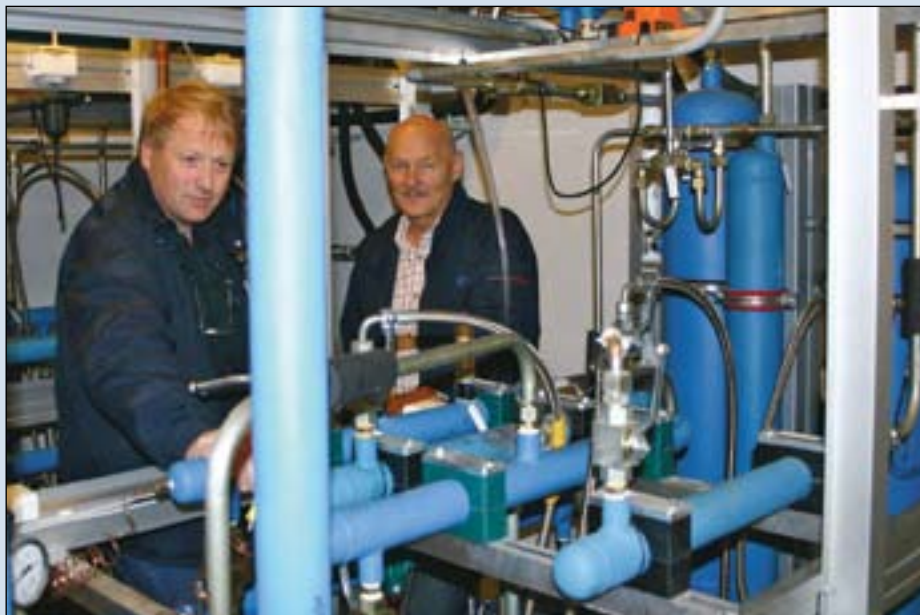
Det slår en umiddelbart at rørene har mye mindre dimensjoner enn hva man er vant med. Men å finne de riktige rørtyper er i seg selv en vanskelig oppgave. Legg også merke til sikringene av rørslangen slik at man unngår ulykker om disse løsner. Bjørn Flåøyen (t. v.) er Leif Grøvers kompanjong.
