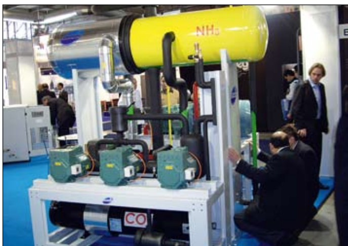
CO 2 -anlegg i kombinasjon med ammoniakk kommer for fullt.
