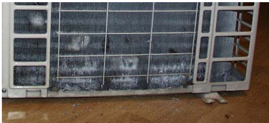
Figur 4.5 Korroderte lameller på en utevarmeveksler for en luft/luft varmepumpe.
