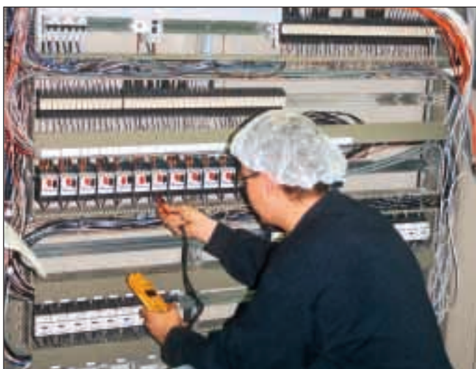
Alt hår skal tildekkes selv om man arbeider med innregulering og opplegg av det elektriske anlegget
