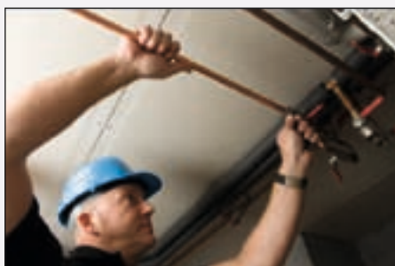
Lurt å få sjekket vannrør og koplinger, de har begrenset levetid. (Foto: Varme & Bad)
