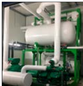
37 Hybrid høytemperatur varme-pumpe til Bergen
