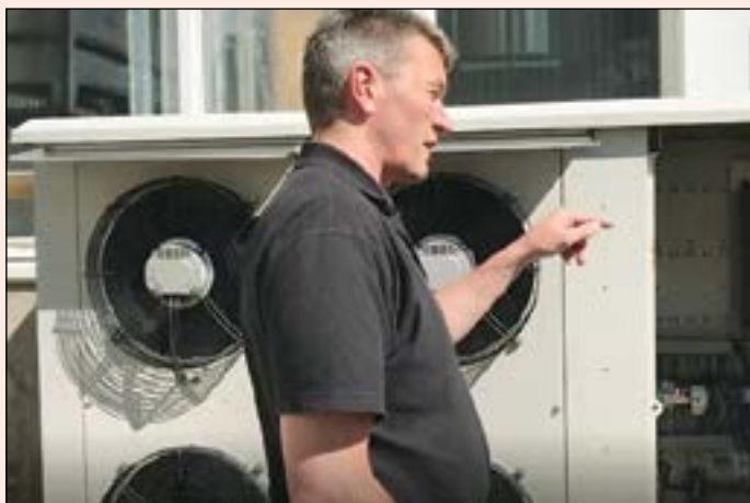
Meieribestyrer Trond Lund i Rørosmeieriet foran meieriets nye varmepumper. Foto: Rørosmeieriet/Nina Sahraoui.
