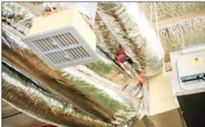
Å fjerne et teknisk luftesystem gjør det mulig å bruke noen ekstra kvadratmeter til noe annet. Foto: Colourbox
