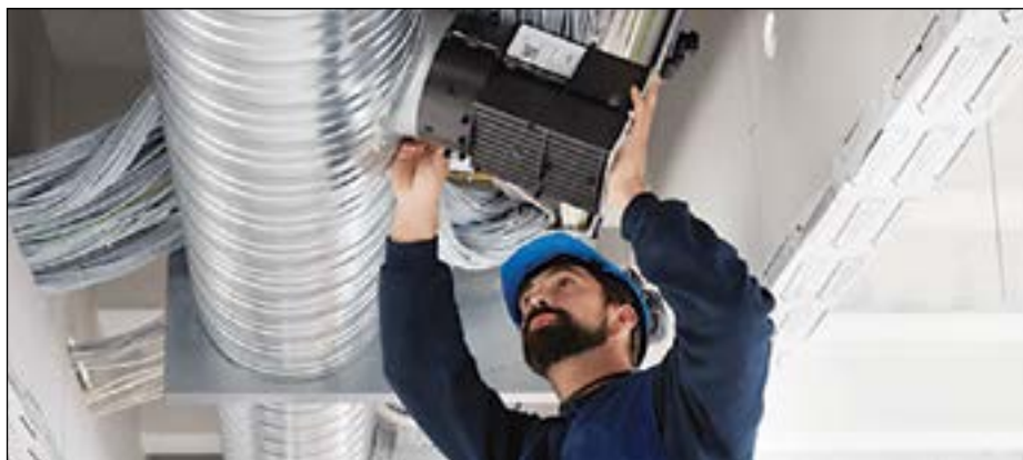
En ventilasjonstekniker må beherske spennet mellom strømningsmeknikk, termodynamikk og elektronikk og kunne justere sensorer og pådragsapparater, slik at resultatet blir optimalisert energiforbruk og god luftkvalitet.
