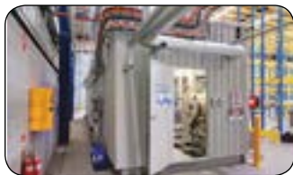
76 Centrale køleanlæg med lav NH 3 fyldning
